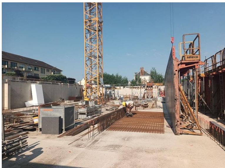
Construction du centre aquatique Poursuite des travaux tout au long de l'année 2023 (photo prise en juin 2023)
